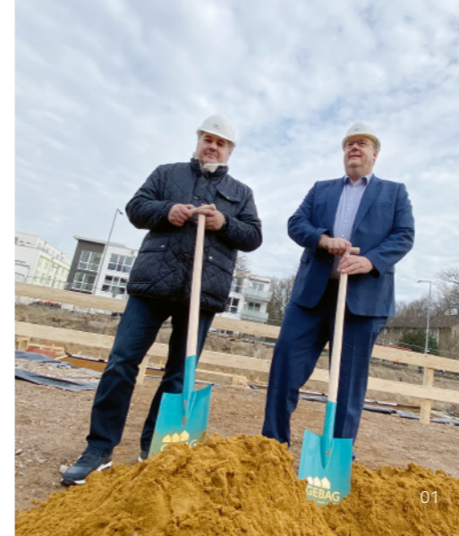
01 Los gehts: GEBAG-Geschäftsführer Bernd Wortmeyer (r.) und GEBAG-Aufsichtsratsvorsitzender Bruno Sagurna beim Spatenstich für den Neubau in Meiderich
